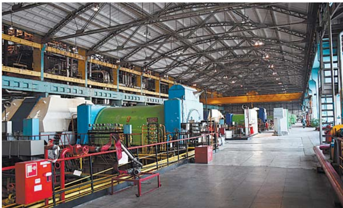
Трудовая начинка котлотурбинного цеха №2 - его машинный зал
