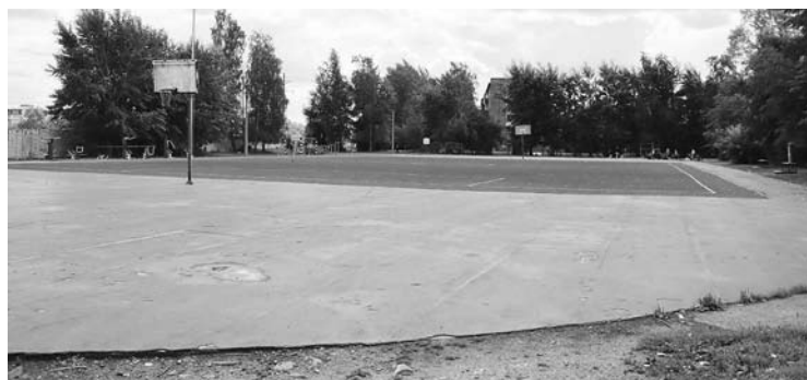
Изношенная беговая дорожка стала небезопасной
