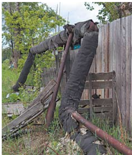
Коммуникации значительно устарели
